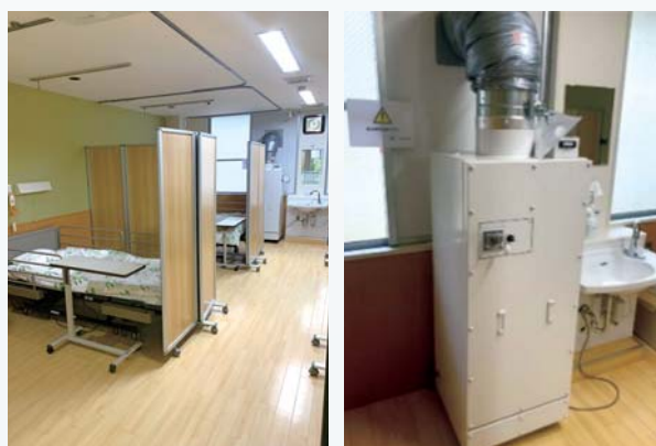
病室には医療用の陰圧装置を設置しています。
